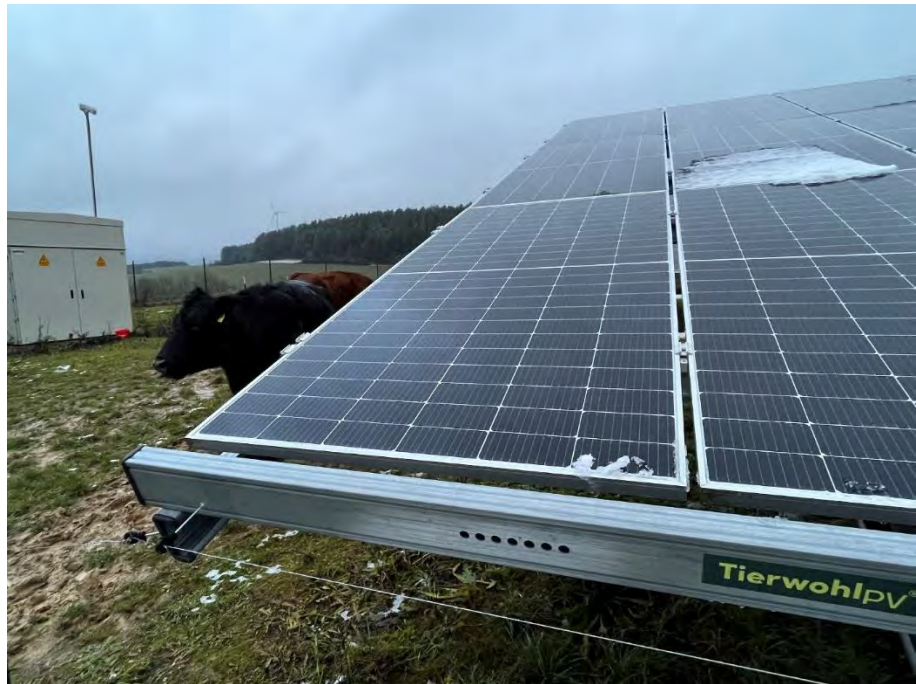
Foto 1: Stromlitzenzühren am Rammschutz
